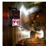
IRLANDA Controllo delle Pompe di Sentina del Tunnel al Porto di Dublino
